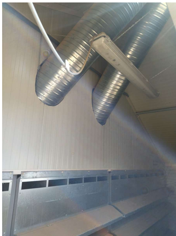
Tuyaux servant de réservoir pour l'alimentation
