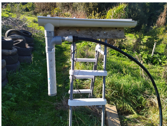
Récupération de l'eau d'une gouttière + filtre à sédiments
