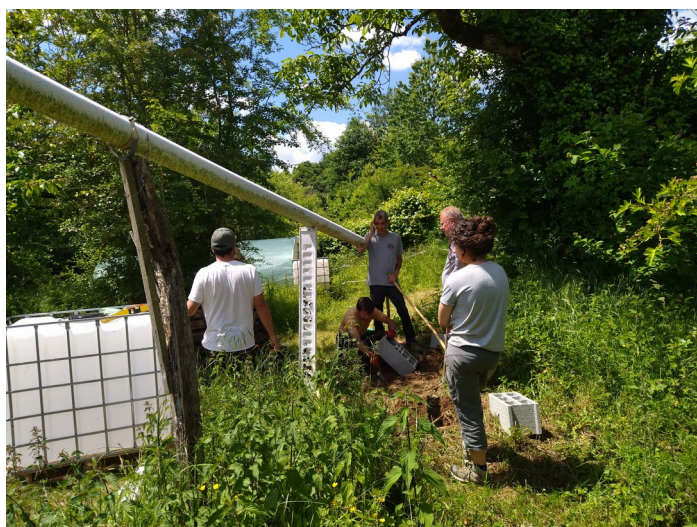
Nouvelle cuve, au fond la serre et la 2e cuve
